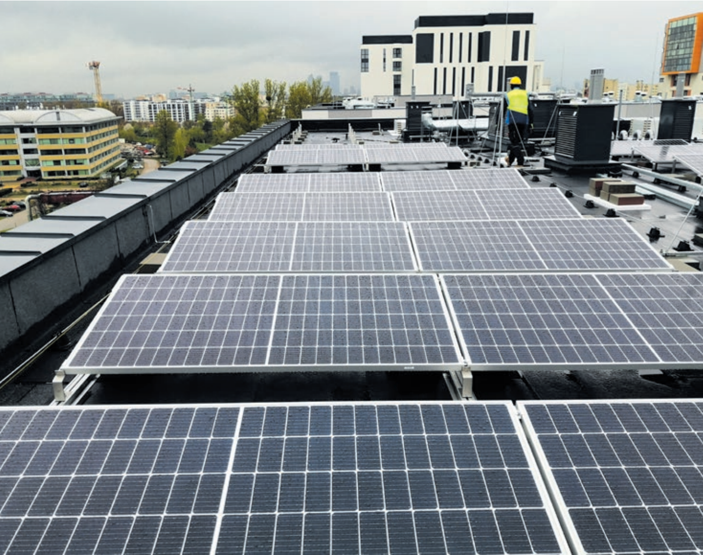
Instalacja fotowoltaiczna wykonana przez PVGE Fotowoltaika
